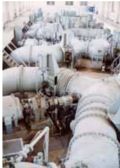
排水機場 内部 ポンプの設置状況
