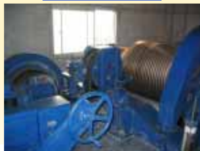
ゲート巻上げ機
