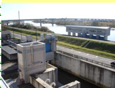
排水機場吐水槽
