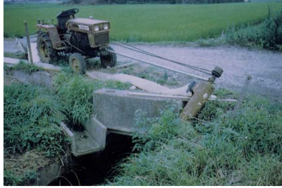
仮設揚水ポンプの設置②（トラクターの動力を利用） 用排水路が分離されている地域においては、排水路に各種の動力源による揚水ポンプを設置して水の反復利用を図った。
