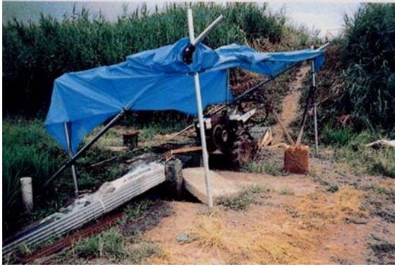
仮設揚水ポンプの設置①（耕耘機の動力を利用） 用排水路が分離されている地域においては、排水路に各種の動力源による揚水ポンプを設置して水の反復利用を図った。
